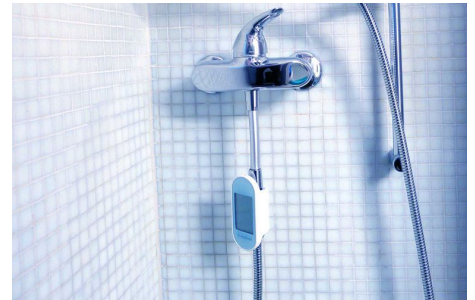
Um die genauen Einsparungen berechnen zu können, wurde bei mehr als 100 Verbrauchern der Warmwasserkonsum über ein halbes Jahr gemessen und ausgewertet. Bild: myclimate
