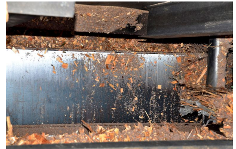
Gemischte Biomasse wird in den Biomasseboiler gefüllt.
