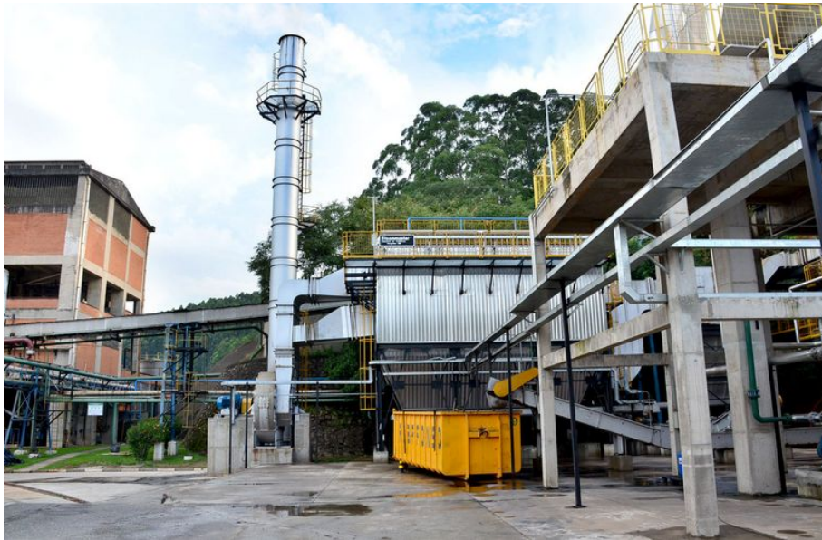
Melhoramentos Papeis Biomasseboiler in deren Zellstoff- und Papierfabrik in Caeiras, Sao Paulo, Brasilien.
