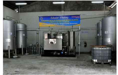
Installierte Anlage im Nordwesten Denpasars, wohin das eingesammelte Altöl gebracht wurde.
