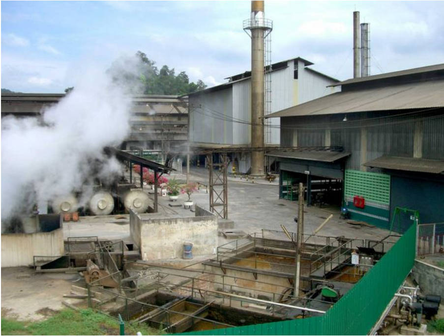
Die Abwasseranlage der Palmölfabrik wird durch das Projekt weniger klimaschädlich.
