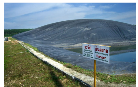
Mit Methangas angereicherte Abdeckung.
